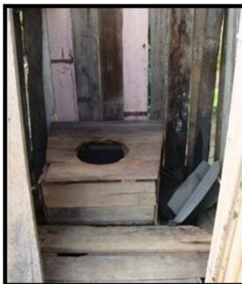
Figura 5 - Fossa rudimentar na Vila da Ressaca da Pedreira-AP.
