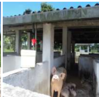
Figura 07. Instalação do coletor de águas pluviais na calha do telhado da suinocultura.
