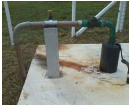
Figura 02. Vista do poço artesiano com Profundidade de 70m do IFPA - Campus Castanhal.
